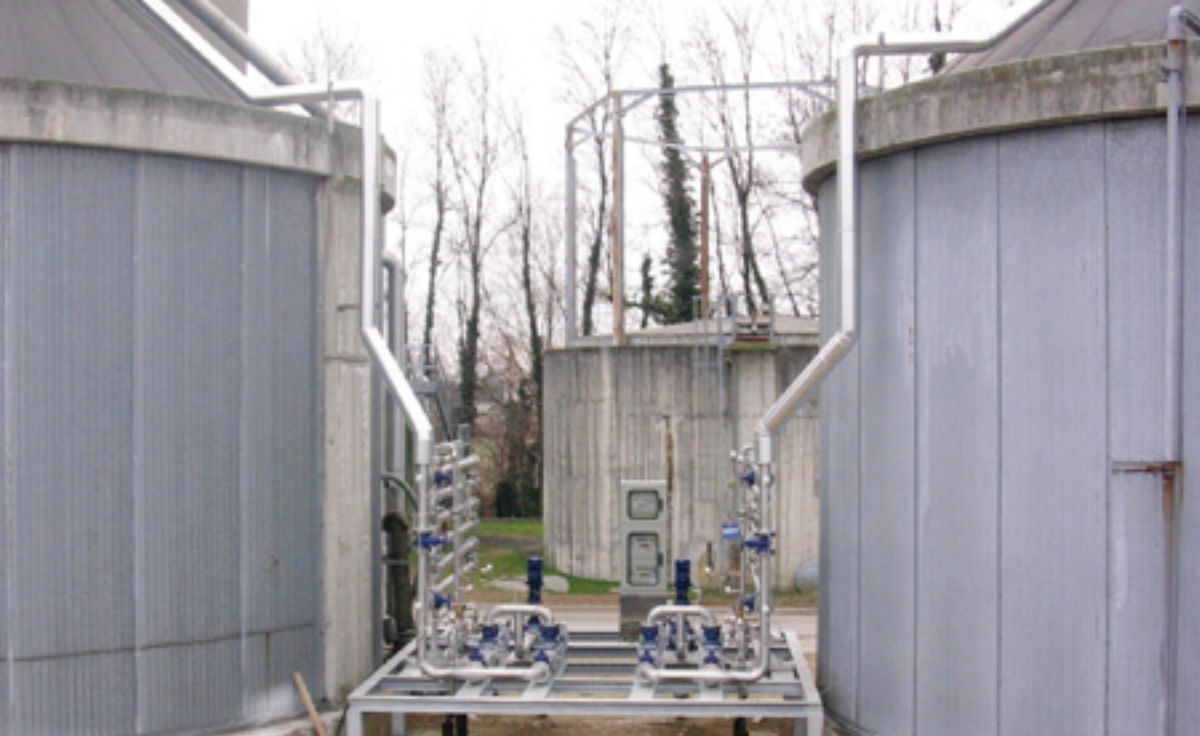
Impianto di scambio di calore per fanghi – Cittadella (PD)
