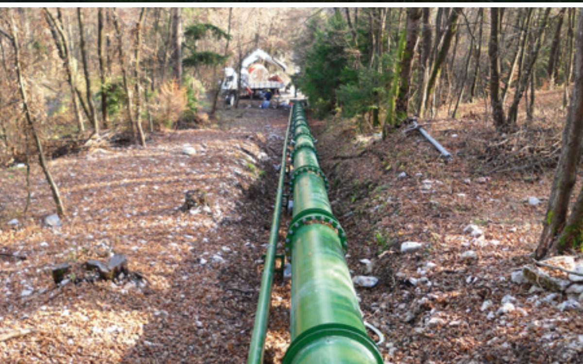
Condotta forzata per impianto idroelettrico – Pedavena (BL)
