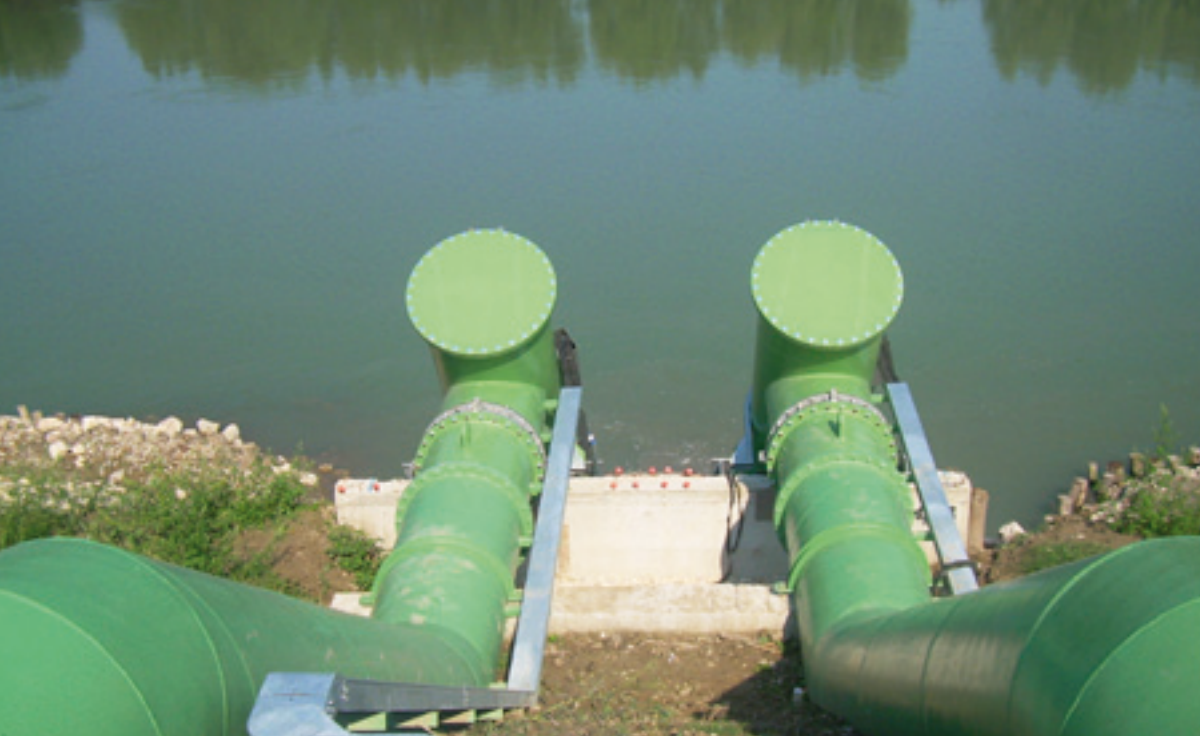
Impianto di sollevamento acque di irrigazione – Cantonazzo (RO)
