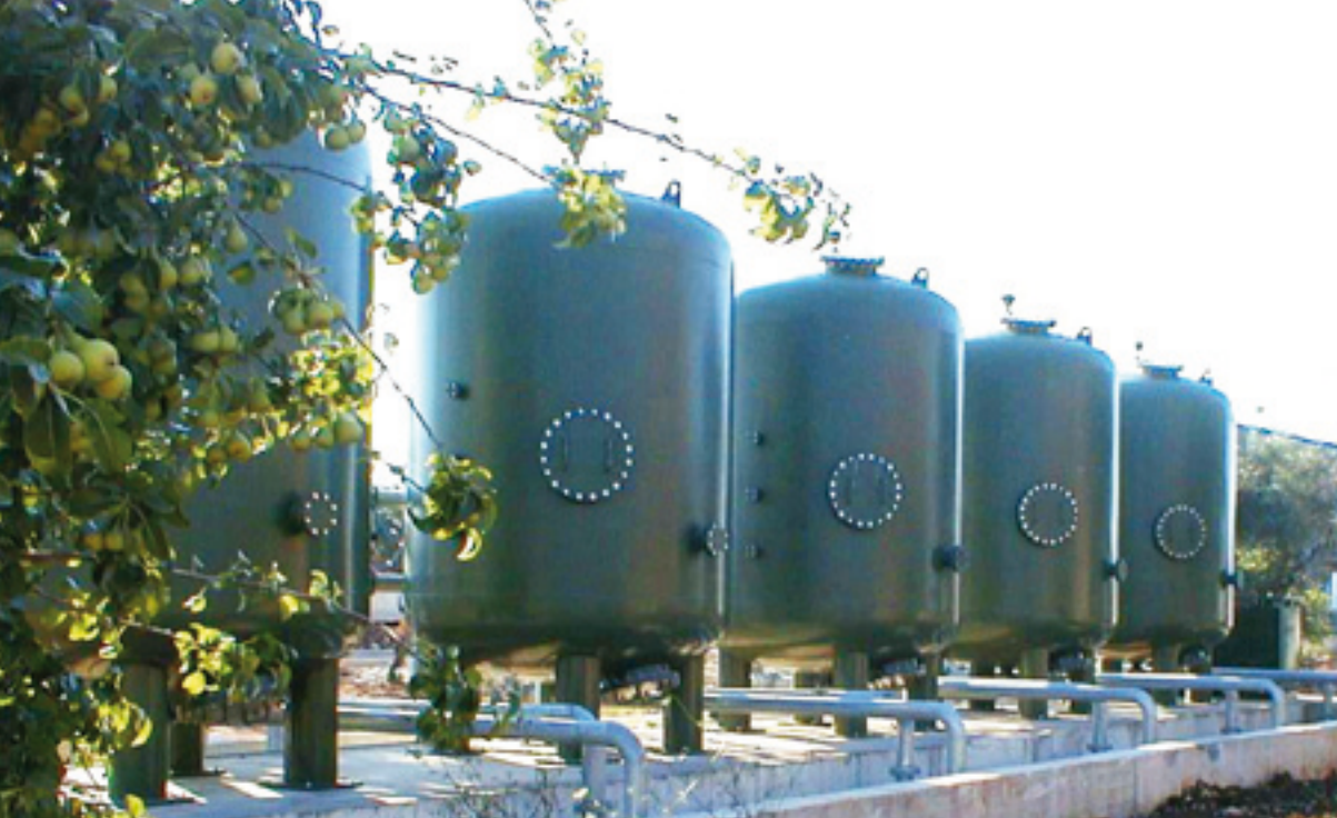
Impianto di filtrazione a sabbia in pressione – Modugno (BA)
